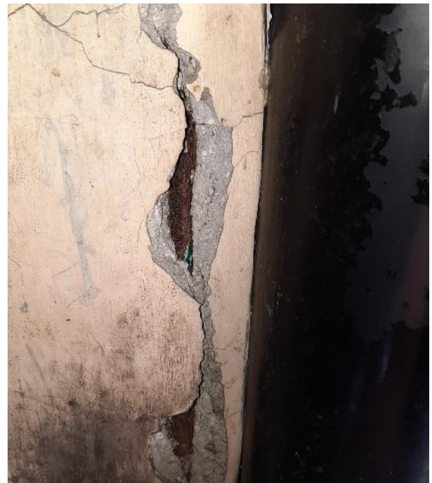
Figura 5.7. Componentes de una estructura con visible daño en el concreto y el acero de refuerzo
