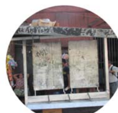
Mobiliario dañado y mal ubicados
