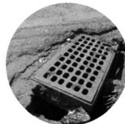
Daños en Infraestructura
